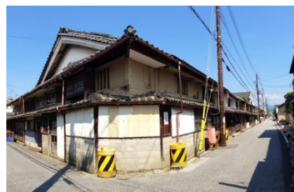
保存修理が必要な歴史的建造物
