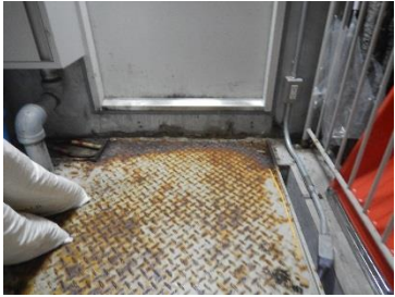
PH-1 デッキ部分の錆
