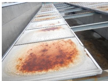
5E-8水溜まり錆あり
