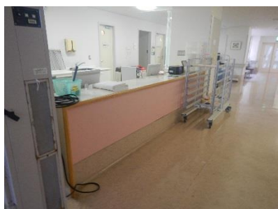
7F-1 造作家具破損
