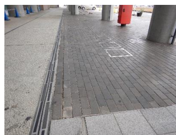
5E-15不陸・段差あり
