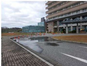
5E-42排水不良
