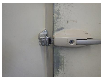
B1F-15 ドアまわり劣化
