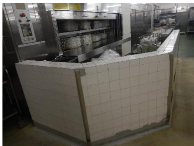
B1F-8タイル割れ
