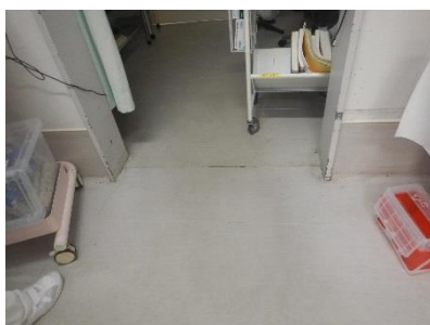
2F-1 塩ビシート劣化
