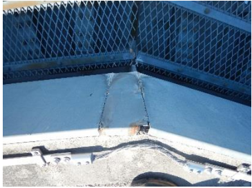
PH-3 パラペット錆、一部破損
