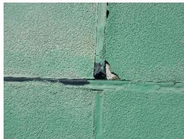
5E-18シーリング劣化
