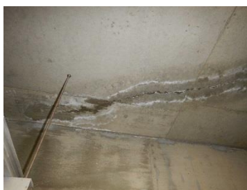
5E-2漏水あり
