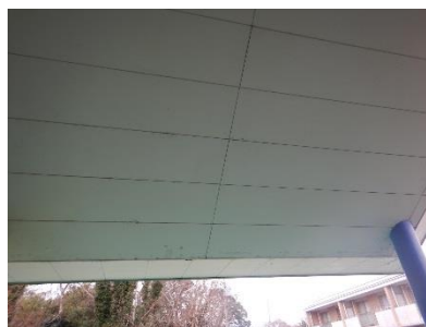
4 軒天塗装劣化
