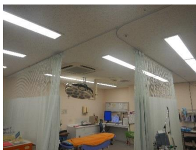
2F-2 カーテンレール落下の事例あり
