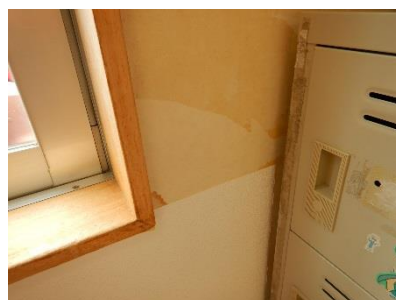
7 壁仕上げ劣化
