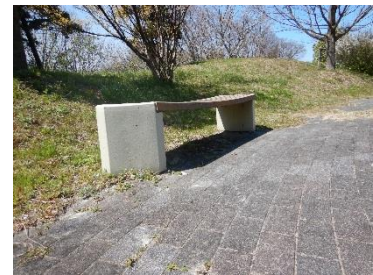
5E-41劣化による湾曲
