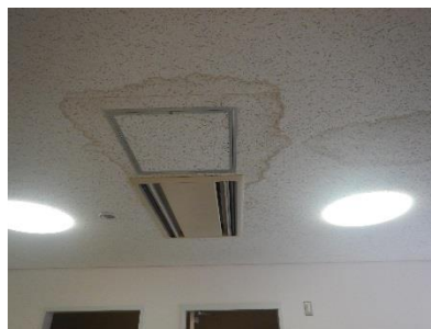
7F-3 漏水跡あり
