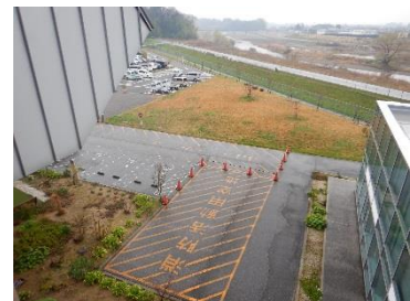
5E-44白線薄い・沈下あり
