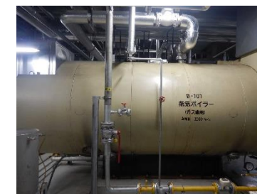
5E-56蒸気ボイラー
