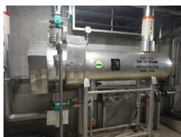
5E-58蒸気一水熱交換器
