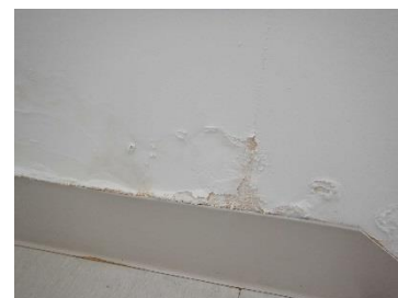
5E-27屋上までの屋内壁損
