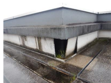
5E-29パラペット立ち上がりパネル破損
