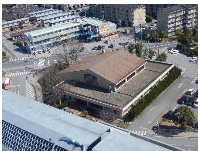
1 全景（屋根鋼板の錆）
