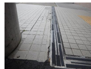
5E-16亀裂・がたつきあり
