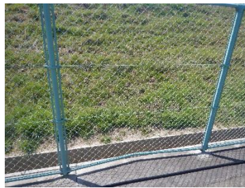
5E-40フェンス損傷
