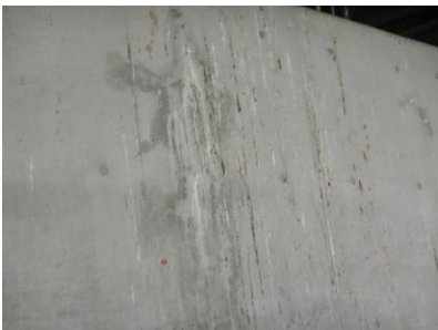
B1F-2 内部の漏水痕
