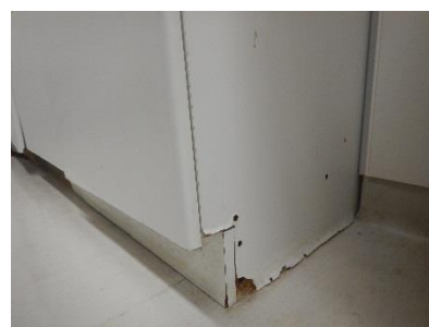
2F-14 洗浄室シンク劣化
