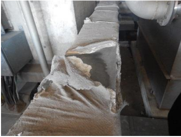
PH-2 耐火被覆破損
