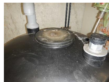
5E-3漏水による溜り
