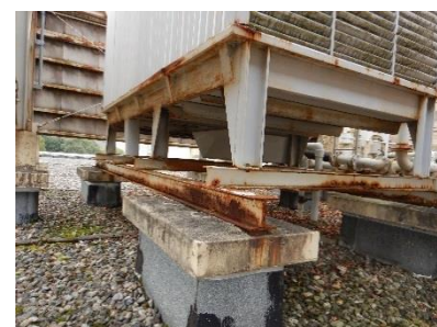
5 設備脚部分の錆
