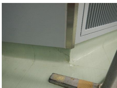
2F-9 手術室5床劣化
