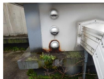
5E-32植物繁茂・設備錆あり
