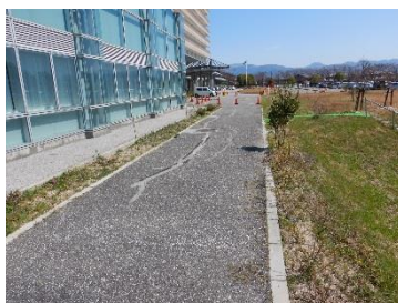
5E-45舗装亀裂
