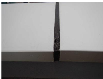
5E-28パラペットシーリング劣化
