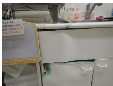
2F-13 洗浄室シンク劣化
