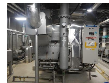
5E-59ガスボイラー
