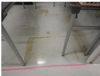
B1F-22 床劣化、亀裂あり
