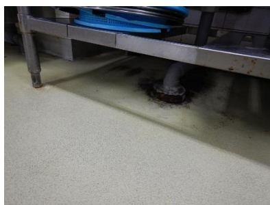
1F-2 床劣化破損
