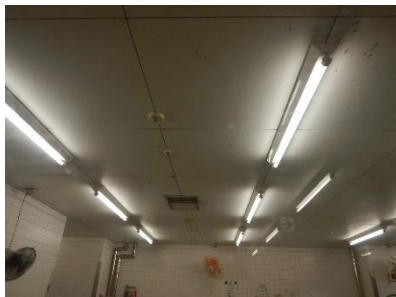
B1F-11 照明交換
