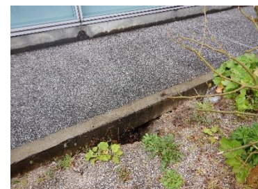
5E-47地盤沈下あり
