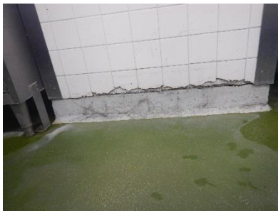
B1F-12 壁・配管劣化
