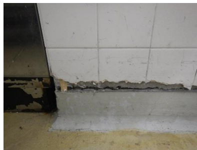
B1F-18 タイル割れ劣化
