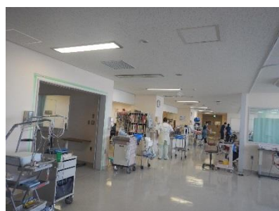
2F-3 壁塗装劣化
