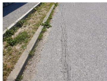
5E-46舗装亀裂
