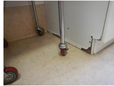
7F-4 シンク台破損
