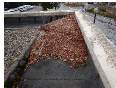
3 モルタル笠木割れ・屋上の枯葉
