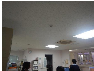
4F-2 天井漏水跡あり
