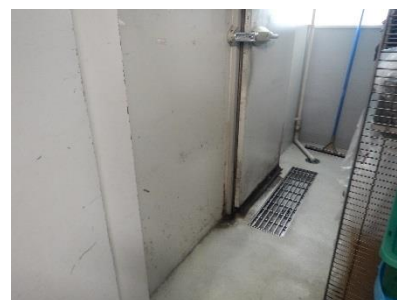
1F-3 壁、床経年劣化
