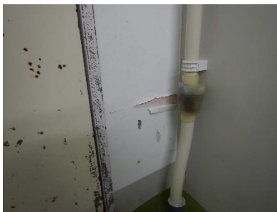
B1F-9壁・配管はがれ・割れ
