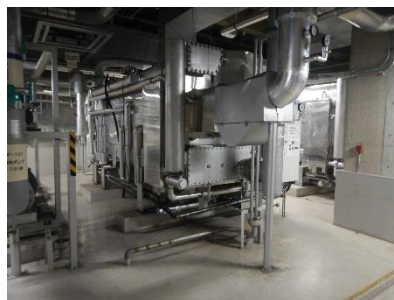
ガス専焼炉筒煙管式ボイラー B1F-27 問題なし
