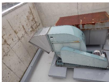
5E-30設備屋根錆あり
