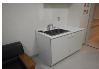
B1F-5 流し台劣化
