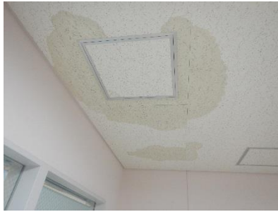
4F-1 天井漏水跡あり
