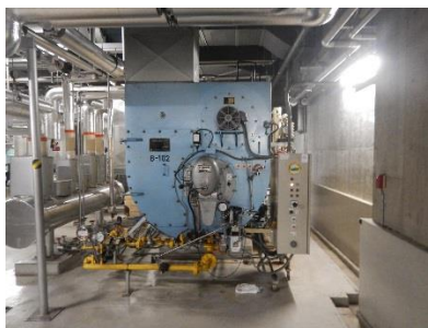
ガス・灯油兼用焼炉筒煙管式ボイラー B1F-25 問題なし
