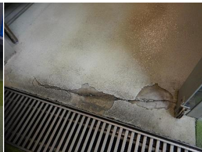
B1F-13 防水塗装はがれ・割れ
