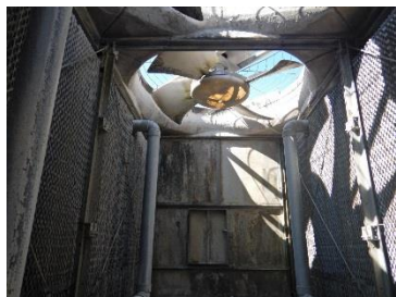
5E-51チラー内部
