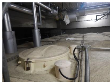
5E-54受水槽上部
