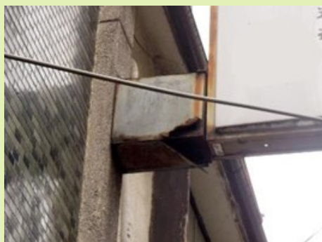
接合部の腐食
