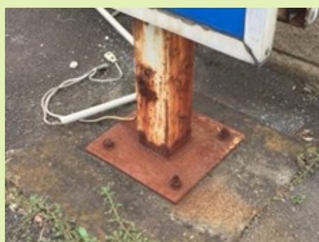
支柱根元の腐食
