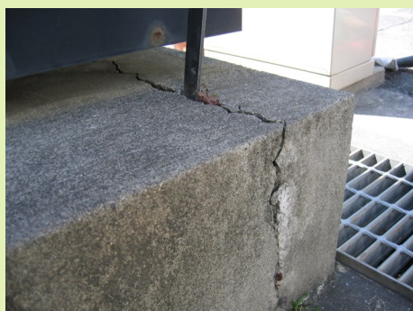
基礎の老朽化
