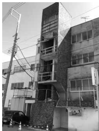
▶ 大東町にある外壁が崩落した民間ビル
