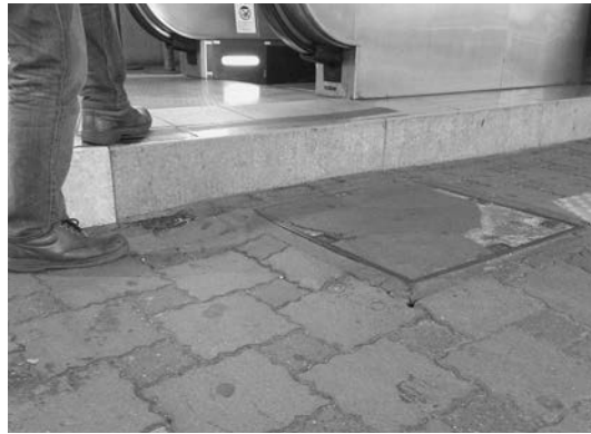
▲彦根駅西口の登り口付近のブロック損傷と段差
