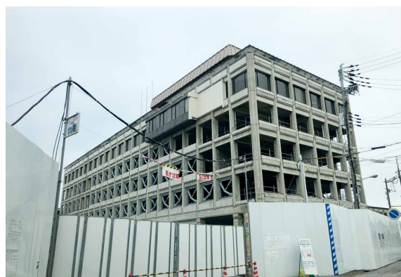
▲耐震化工事が中断している彦根市役所
