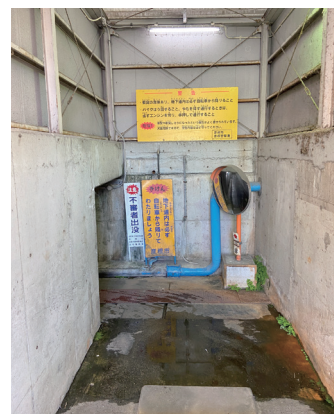
▲安全対策等の整備が必要な地下道（古沢町）
