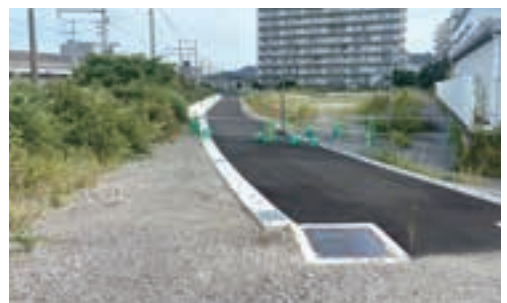
▲今年度末に進捗率27%となる予定の猿ヶ瀬川の改修工事の現状
