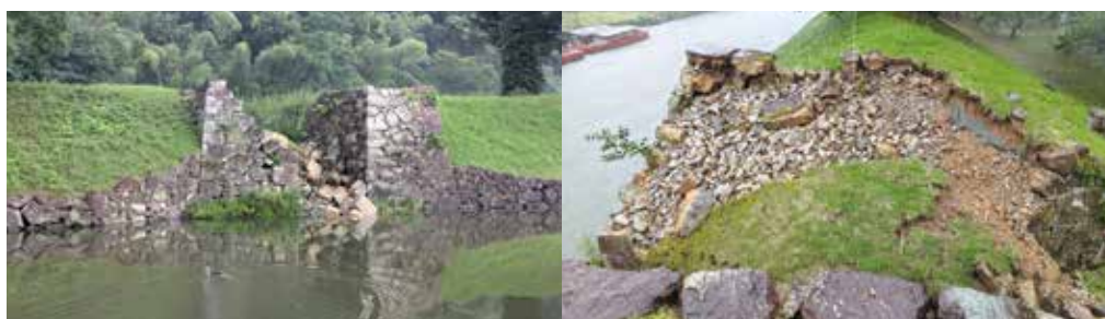
▲崩落した米蔵水門石垣の様子
