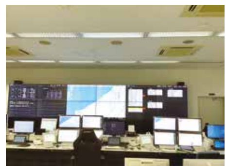
▲彦根市消防本署1階の通信指令室の状況
