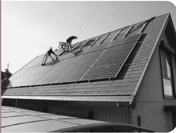
▲住宅用太陽光パネル
