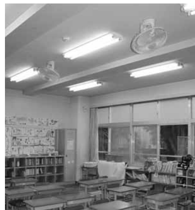
現状は扇風機のみ
