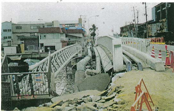
写真（左） 水管橋部鋼管の座屈等
