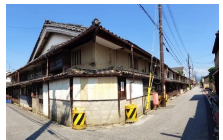
保存修理が必要な歴史的建造物
