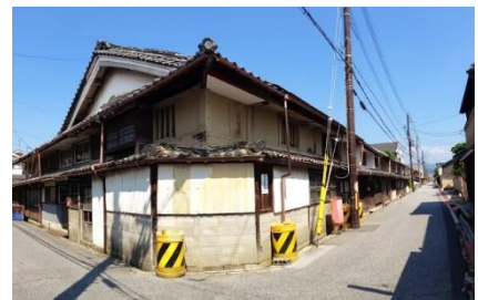
保存修理が必要な歴史的建造物
