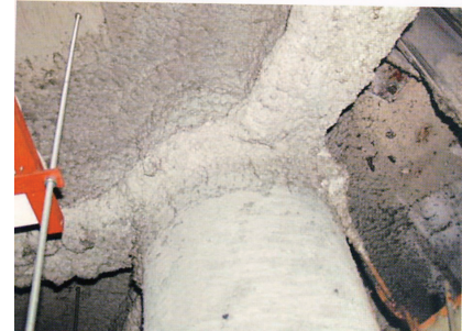
▲出典：国土交通省資料「目で見えるアスベスト建材レベル 1」
