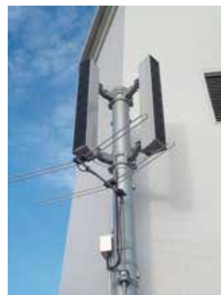
市役所（本庁舎）に配置している 防災スピーカー
