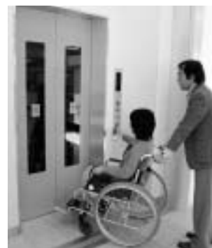
南彦根駅に設置したエレベーター
