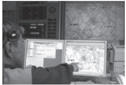
▲消防本部にある緊急通信指令台
