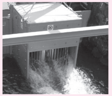
▲大分県日田（ひた）市で稼働する小水力発電
