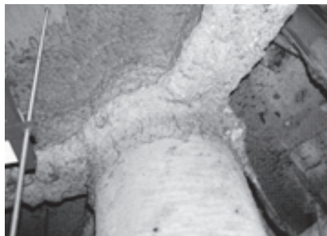
◀国土交通省資料「目で見えるアスベスト建材レベル」より
