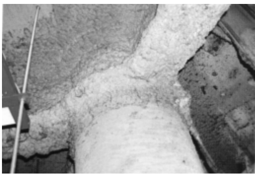
▶出所 国土交通省資料 [目で見るアスベスト建材レベル1]
