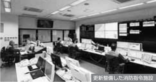
更新整備した消防指令施設
