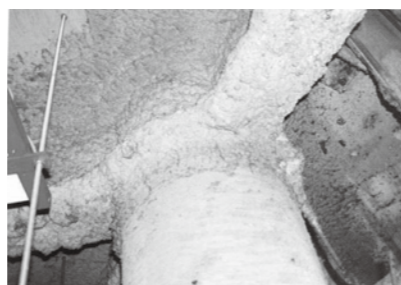
出所 国土交通省資料「目で見るアスベスト建材レベル1」
